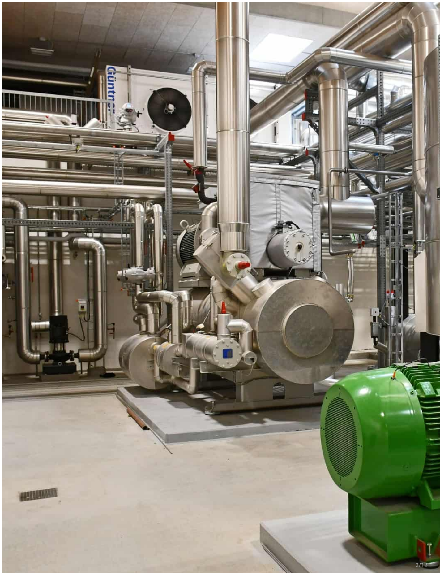
Med etableringen af kæmpestore varmepumper er Viborg Varme godt på vej til helt at skippe gassen. Foto: Niels-Chr. Jönsson
